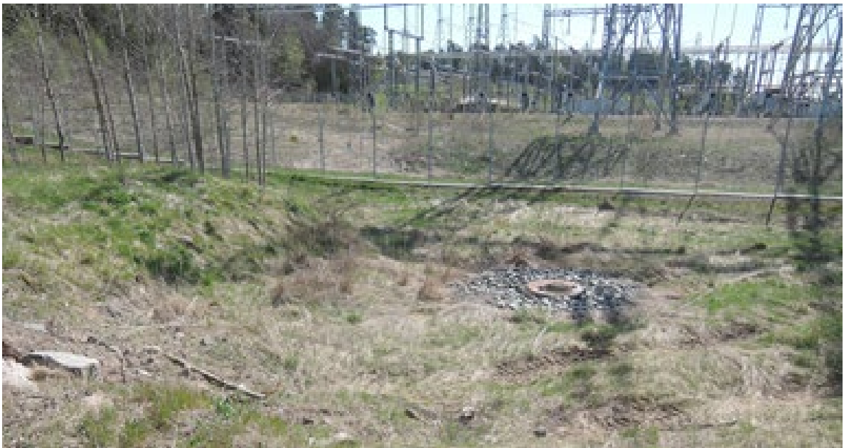
Utsläppet för de befintliga dagvattenledningarna i betong. Brunnen leder ner i ledning under mottagningsstationen.
