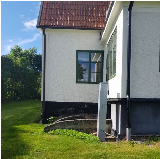
Bilden visar stuprör som leds ned i marken från befintlig byggnad. Källa: Dagvattenutredningen
